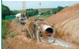
Baustellen tragen laut Umweltbundesamt österreichweit rund 8% zu den gesamten PM10-Emissionen bei.
